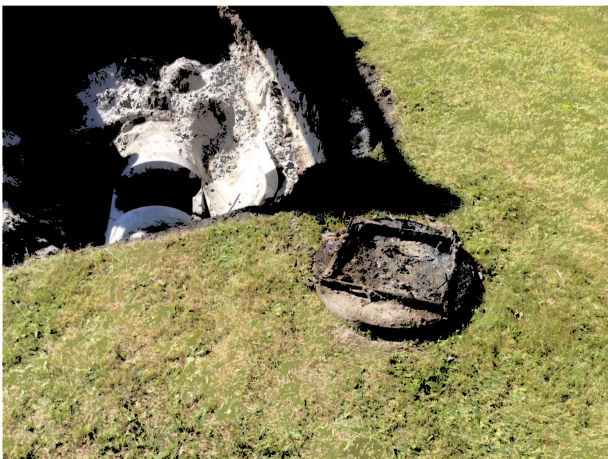
Figur 4: Eldre kumløkk sittende fast i avløpsledning fører til begrenset kapasitet (Kongsberg kommune 2017).
