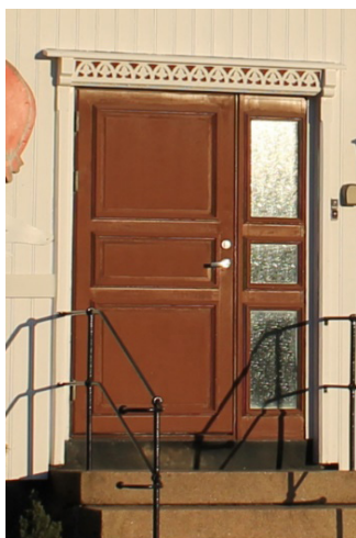
Eksempel på feil inn-setting av ny dør der døren er satt inn i flukt med vegglivet.
