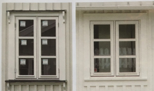
To eksempler på feil vindusutskifting med isolerglass og for kraftige sprosser.
