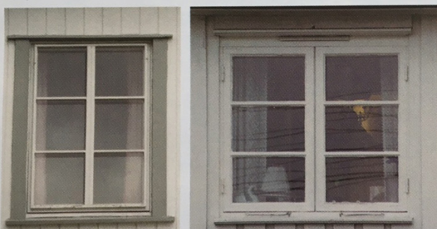
Feil utførelse, varevindu på utsiden
