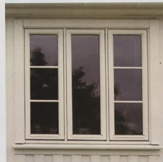
Feil vindusutskifting med trefagsinndeling og empire-sprosser på de ytterste fagene.
