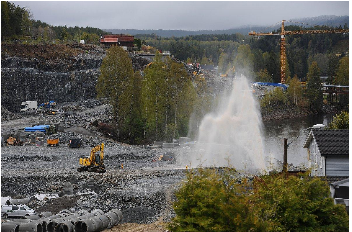
Bilde: Ledningsbrudd på kommunal hovedledning (Laagendalsposten).
