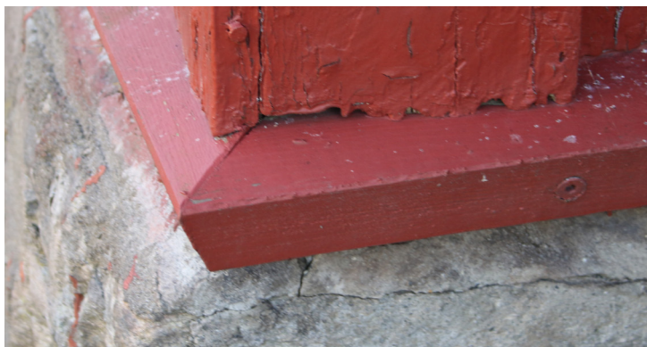
Vannbrett nedre kant panel.
